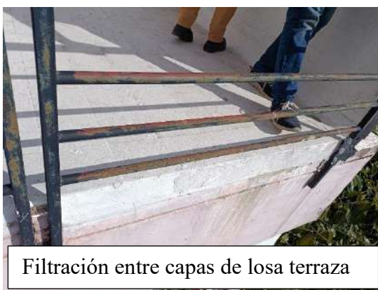
Pluvial en terraza
